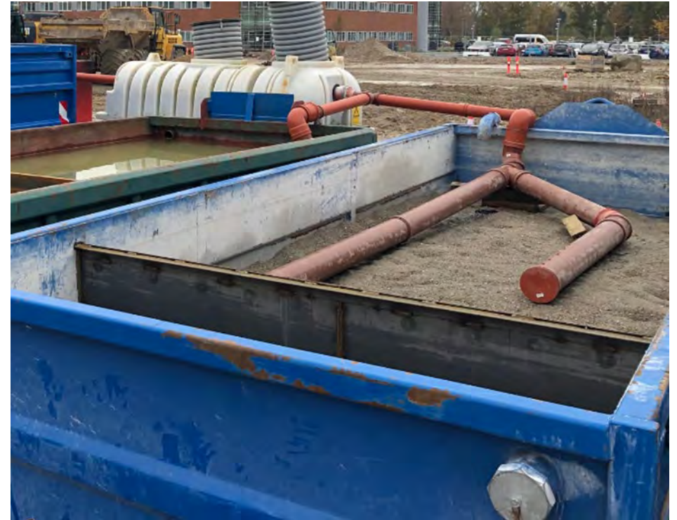
Billedet viser et sandfilter. Et Blueguard filter kan etableres på eksakt samme måde.
